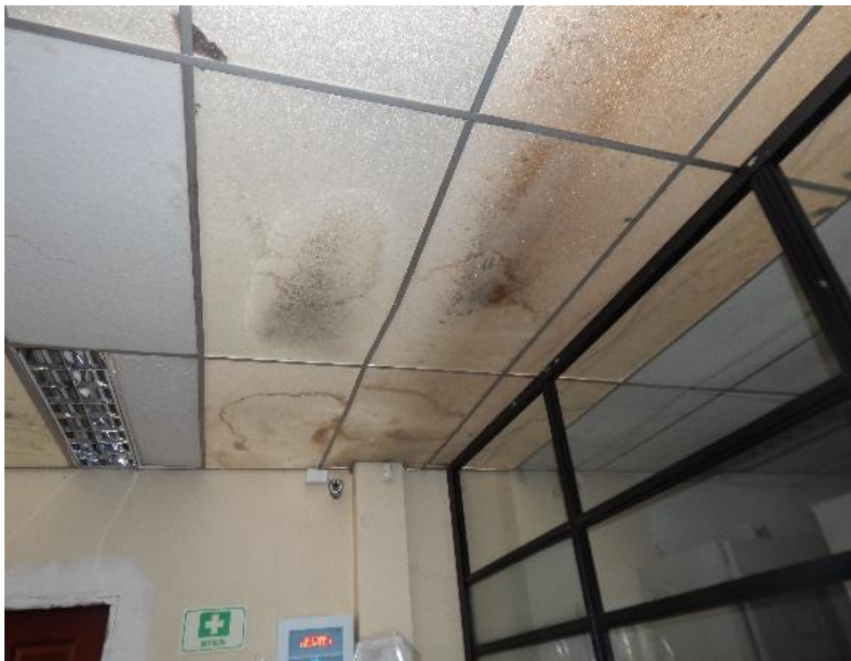
Ilustración 77 Deterioro de cielorraso por humedad. Bloque A
