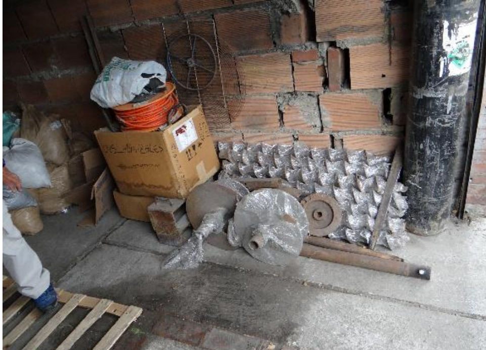
Ilustración 76. Muro deteriorado en bodega. Bloque D
